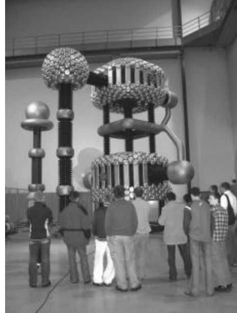
Abbildung: Erläuterung zur Wechselspannungs-Prüfanlage
